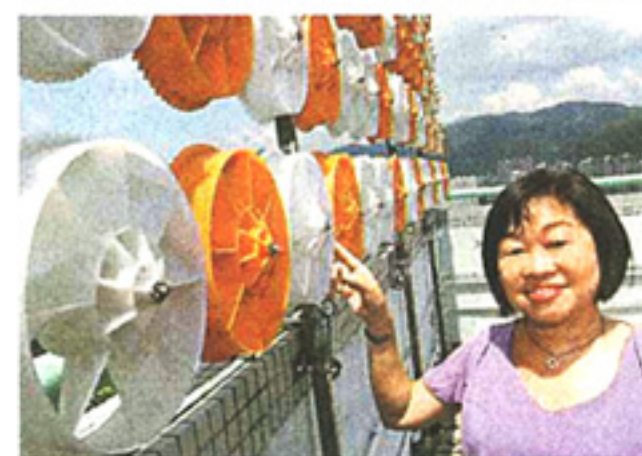
▲鄰舍輔導會服務總監（怡欣山莊）危美玉身後的小型風力發電機，主要為親子渡假家居外的照明系統供電。
